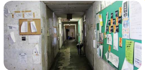
通路は薄暗く、床のタイルも随所ではがれている
