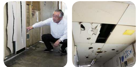
左：破れたまま修繕が放置された部室の壁 右：老朽化で天井板が落ちて大小の穴が開いた通路の天井
